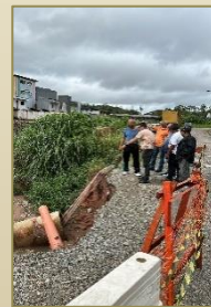
Figura 2 - Dia 23/03, Solapamento com danos à via - Rua Anita Garibaldi, Bairro Santana.
