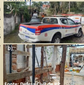
Figura 2: 20/02: Queda de árvores em via pública devido a um temporal (a). 28/12: Queda de muro em R. Diamantino Oliveira, Jardim Pastoril (b).
